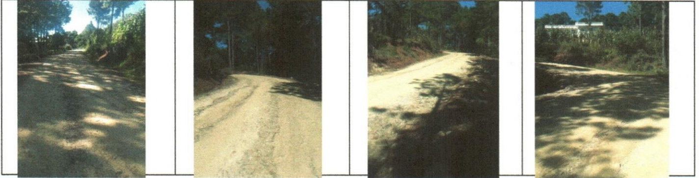
MEJORAMIENTO CAMINO RURAL, PARAJE CHIKIABL, ALDEA PABATOC, SAN FRANCISCO EL ALTO, TOTONICAPAN
