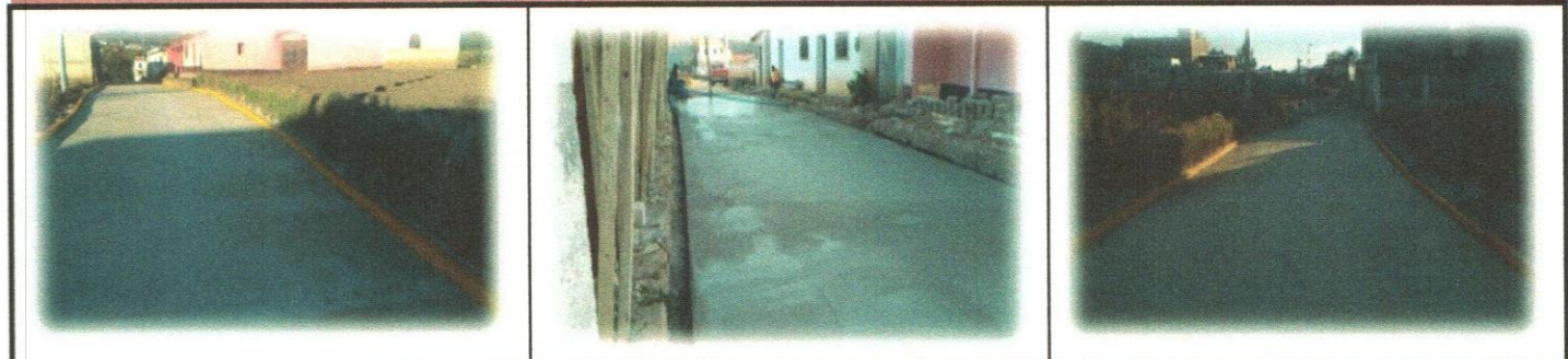
MEJORAMIENTO CAMINO RURAL , CAMINO REAL SECTOR II, ALDEA SACMIXIT, SAN FRANCISCO EL ALTO, TOTONICAPAN
