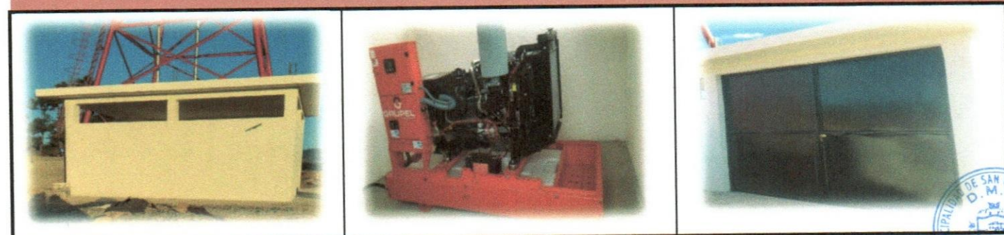
22. MEJORAMIENTO POZO (S) MECANICO Y EQUIPAMIENTO, SECTOR 3 PARAJE TZANJUYUB, ALDEA SACMIXIT, SAN FRANCISCO EL ALTO, TOTONICAPAN
