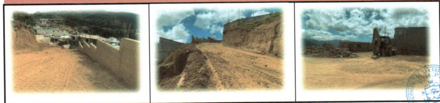
32. MEJORAMIENTO CALLE ENTRE FINAL DE LA 5TA AVENIDA Y 5TA CALLE ZONA 1, ENTRADA HACIA CAMPO DE FUTBOL, SAN FRANCISCO EL ALTO, TOTONICAPAN
