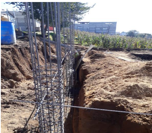
INSPECCION OCULAR EFECTUADA EN LA PRIMERA AVENIDA CALLEJON "B" DE LA ZONA
