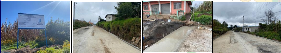
MEJORAMIENTO CAMINO RURAL , PARAJE CHI-HERNANDEZ, ALDEA TACAJALVE, SAN FRANCISCO EL ALTO, TOTONICAPAN
