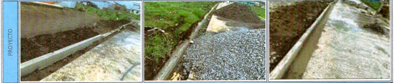
24 MEJORAMIENTO CALLE ZONA 3, VIA A ALDEA SACMIXIT, SAN FRANCISCO EL ALTO, TOTONICAPAN
