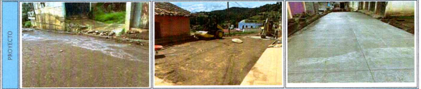
21 MEJORAMIENTO CAMINO RURAL SECTOR CHINIMA PARAJE CHIRIJCruz, ALDEA CHIRRENOX SAN FRANCISCO EL ALTO, TOTONICAPAN
