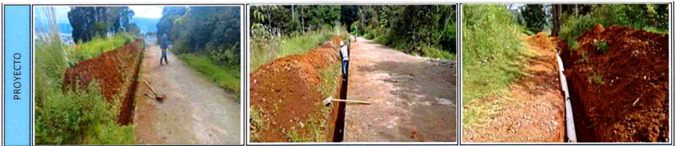
6 CONSTRUCCION SISTEMA DE ALCANTARILLADO SANITARIO , PARAJE XOLCORRAL Y CHIGARCIA, ALDEA SAN ANTONIO SIJA, SAN FRANCISCO EL ALTO, TOTONICAPAN
