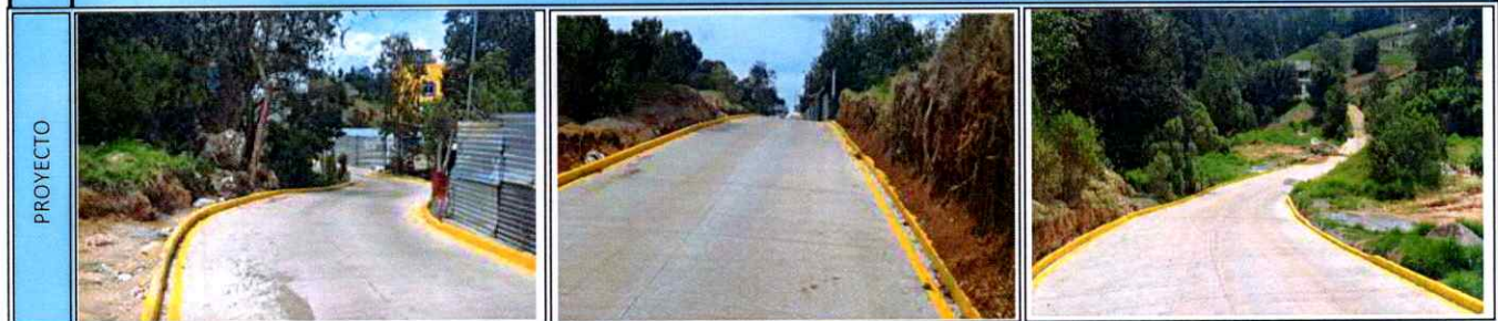
10 MEJORAMIENTO CAMINO RURAL CHI ITZEP, SECTOR TZANJUYUP, ALDEA RANCHO DE TEJA SAN FRANCISCO EL ALTO, TOTONICAPAN
