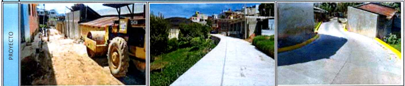
9 MEJORAMIENTO CALLE PARAJE XEGUA PASUC, BARRIO XOLVE ZONA 2 SAN FRANCISCO EL ALTO, TOTONICAPAN
