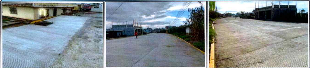
MEJORAMIENTO CAMINO RURAL PARAJE CHUCHAJ ALDEA PACHAJ SAN FRANCISCO EL ALTO, TOTONICAPAN
