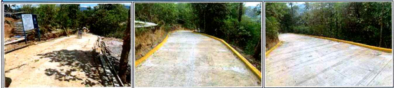
MEJORAMIENTO CAMINO RURAL PARAJE PARRONXOX ALDEA PAXIXIL SAN FRANCISCO EL ALTO, TOTONICAPAN
