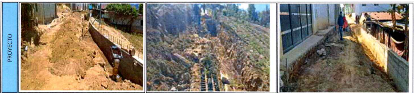
20 MEJORAMIENTO CAMINO RURAL CHALBRIZ, PARAJE CHIJOLOM, BARRIO XOLVE SAN FRANCISCO EL ALTO, TOTONICAPAN
